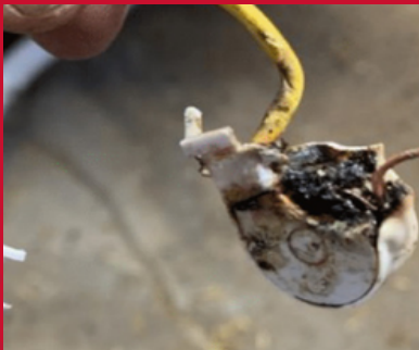
Connecteur de lumière endommagé.
